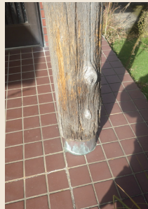
傷んだポーチ柱
