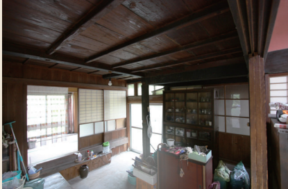
②出入口ももとの欄間に矛盾が生じている
