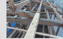
屋根の構造材の取替・補強の様子。新旧の材が繋がる様子は趣深い。
