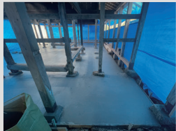
傷んだ構造材や束石の補強・取替をし、床下にコンクリートを打設している。
