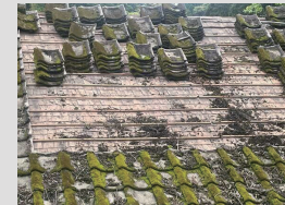
白蟻途中の様子。既存の瓦は割れたり欠けたり苔が生えたり、傷みが大きかった。
