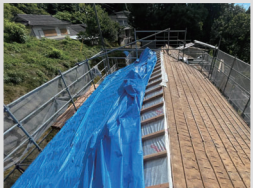
天井現しのため既存の屋根の上に重ねて、新しい屋根をつくっているところ。
