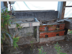
かまどで調理する形のかつての炊事場。壁が崩れ雨ざらして傷みが大きかった。
