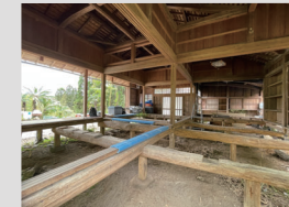
解体がほとんど終わる段階。囲炉裏の煙で燻された立派な構造材が姿を現した。
