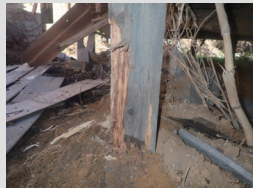
床下が土壌で束石もなく、柱の下部や床下は白蟻被害の痕がありました。
