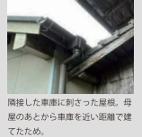
隣接した車庫に刺さった屋根。母屋のあとから車庫を近い距離で建てたため。
